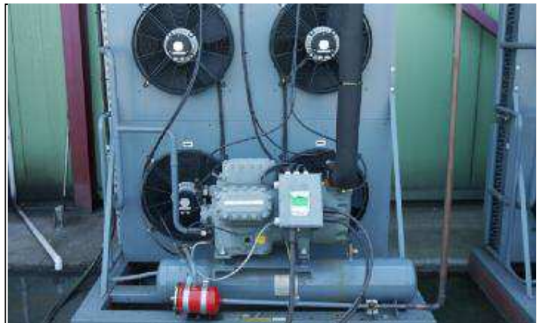
Groupe de refroidissement rapide converti du R404A au RS50 :
