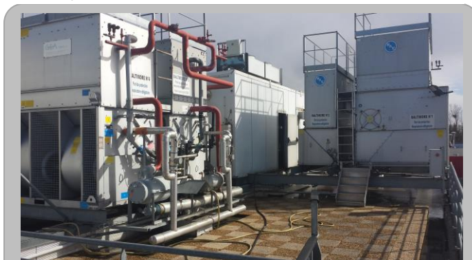
Centrale HP IMEF et condenseurs en toiture
